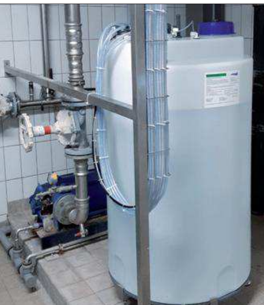
Trotz der vielen Desinfektionsanwendungen ist der Anolyte-Vorratstank so klein wie möglich ausgelegt. Die Just-in-time-Produktion und kurze Wirkstoff-Lagerzeiten garantieren eine hohe Wirkstoffreinheit. So wird die Produktion von Desinfektionsnebenprodukten (THM, Chlorat) auf ein Minimum reduziert. (Bild: Innowatech)
